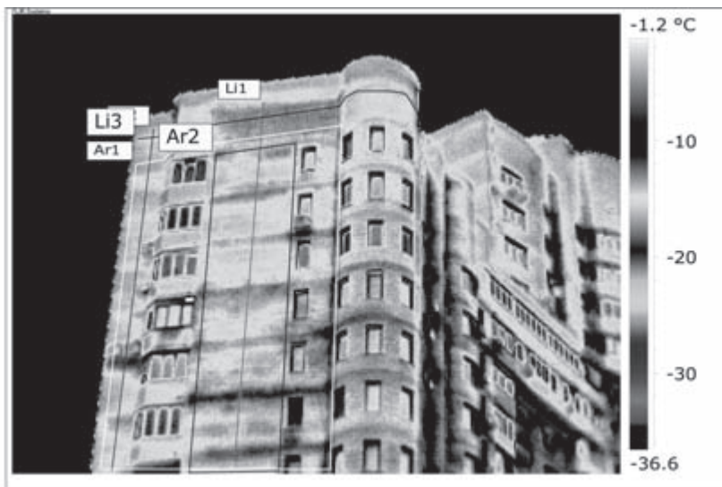
Рис. 3. Термограмма наружной поверхности трехслойной стены с эффективным утеплителем и облицовкой из кирпича. Хорошо просматриваются теплопроводные включения в месте опирания стены на монолитное перекрытие.
